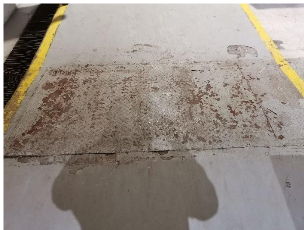
Imagen 13: Desnivel tramo planta química
