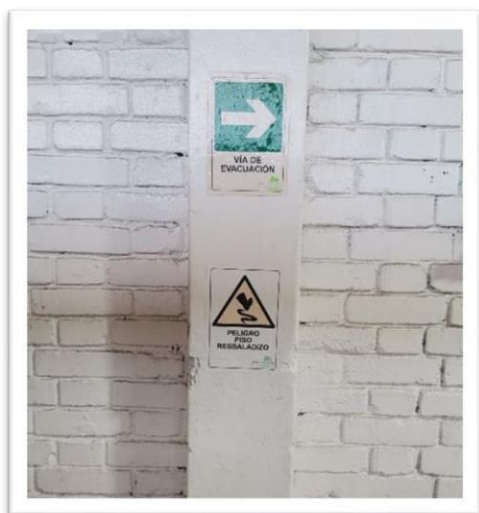
Imagen 14: Señaléticas de precaución de seguridad y vía de evacuación
